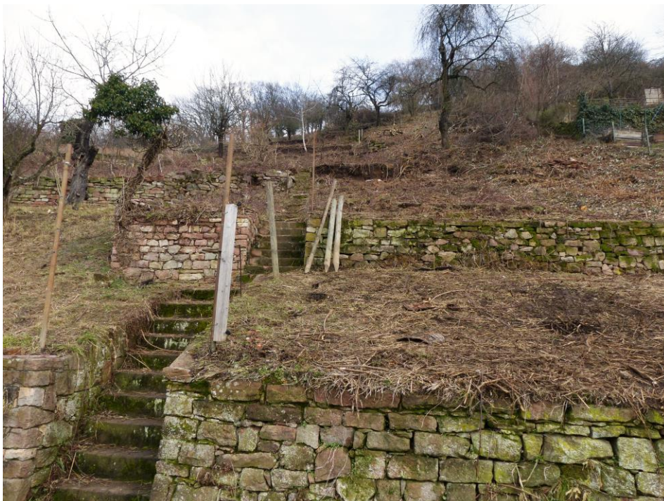
Foto: Trockenmauerhang nach der Erstpflegeaktion (B.Ullrich)
